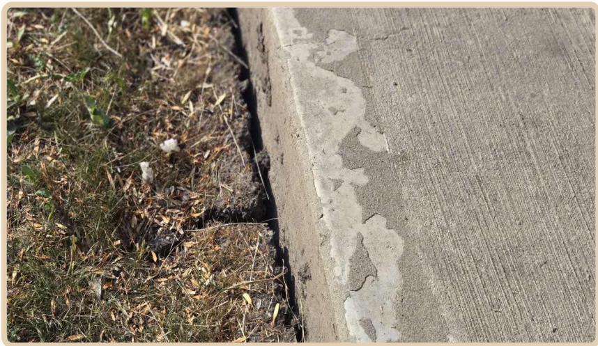
地基下陷，泥土流失
